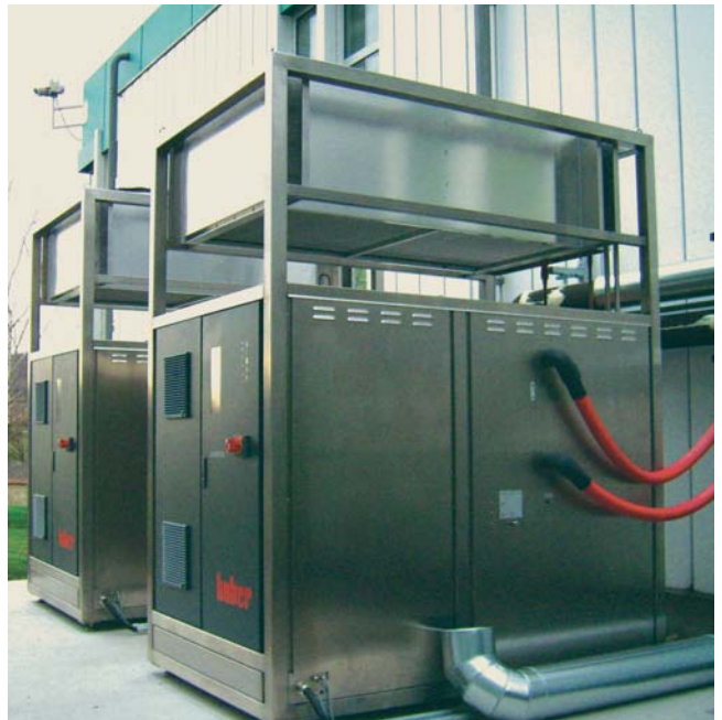
Abb. 10: Heiz/Kühlaggregate sind im Projekt integriert
