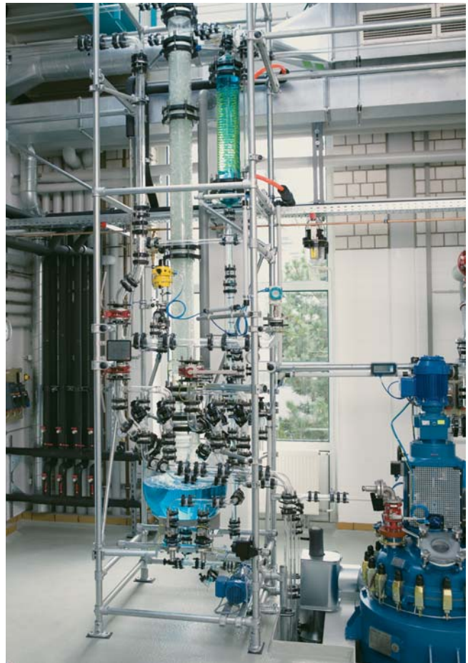
Abb. 6: Chemiewäscher zur Vorreinigung
