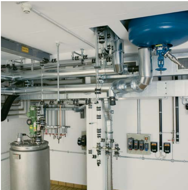
Abb. 8: Produktverrohrung in Glas
