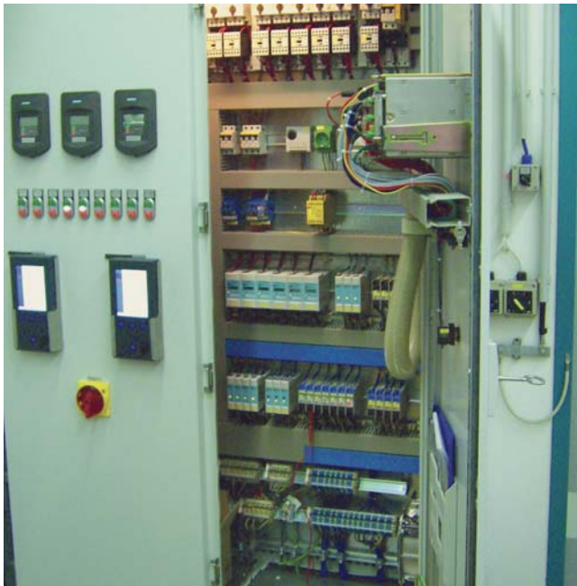
Abb. 7: Schaltschrank in der Messwarte
